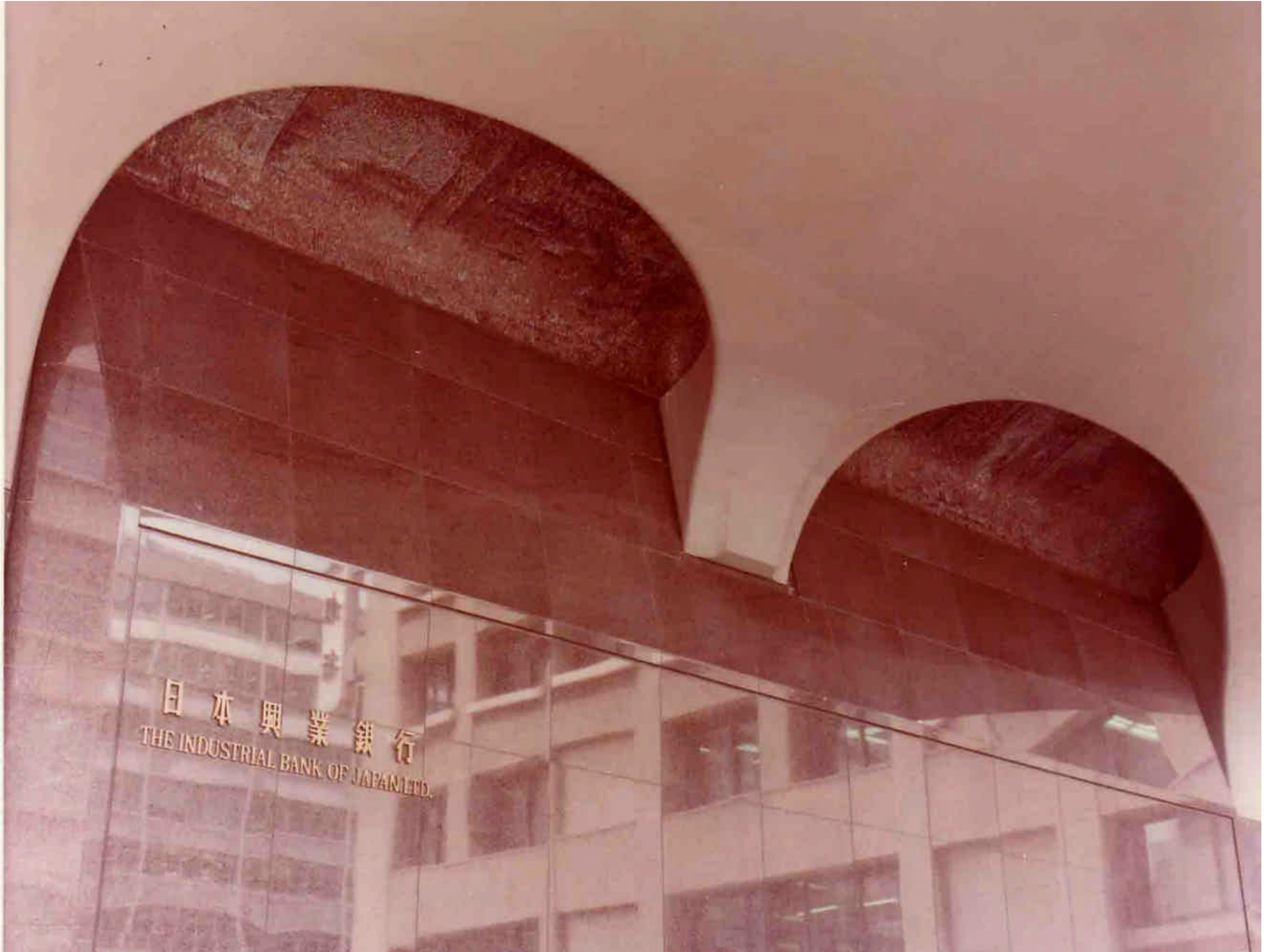
1973年（昭和48年） 東京都 千代田区 日本興業銀行 北側外壁 地下内壁
